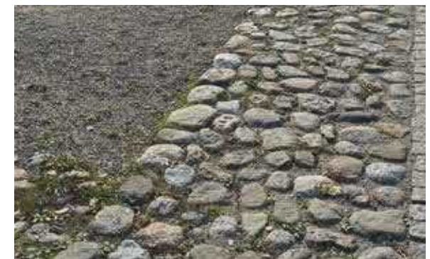
Kuva 35. Alueen erilaiset päällysteet säi- lytetään rajaamattomina niin toisistaan, kuin muista ympäröivistä materiaaleista.
